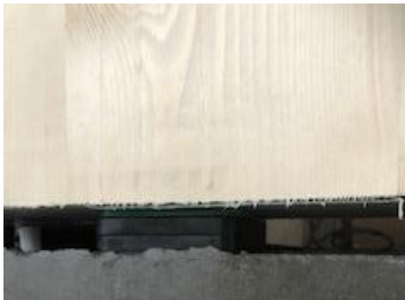
Bild 22. Ytterväggen är placerad på klossar på betonggolvet, 2019-05-08.
