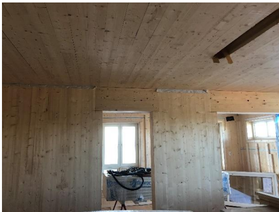
Bild 21. I taket syns ursparning för rör- och ledningsdragnings mellan våningsplanen. Nederbörd läckte ned till underliggande bjälklag via dessa öppningar som var svåra att få täta under stomresningen.
