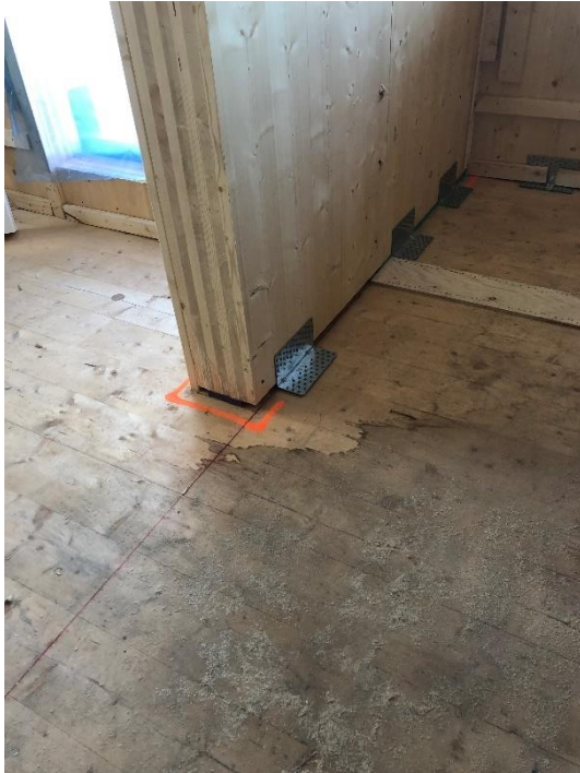
Bild 29. Nederdelen av innervägg. Svart sylomer finns placerad mellan innervägg och bjälklag. Markeringar från missfärgat vatten på bjälklaget.
