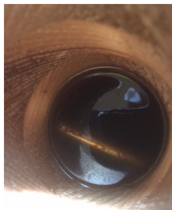
Bild 14. Stående vatten i infästningshål.
