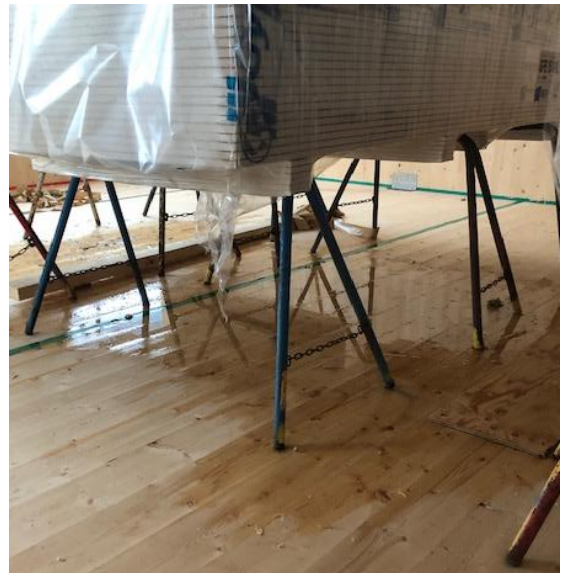
Bild 28. Stående vatten på bjälklag. Vattnet har droppat ner genom ursparing i bjälklaget ovanför. Flera gipsbuntar påträffades blöta inuti på grund av att vatten som droppade ner på emballaget trängde in genom otätheter i plasten.
