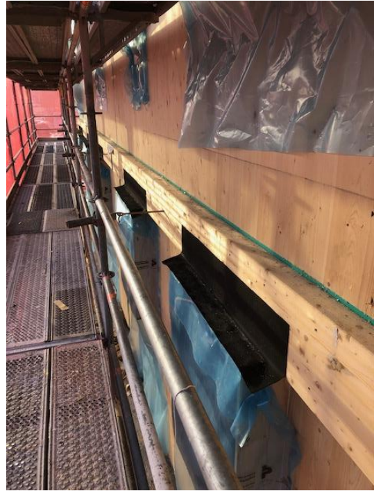
Bild 30. Hus 2, Horisontell balk på utsida av yttervägg, april 2019. Balken blev utsatt för mycket nederbörd eftersom den var placerad utanför vägglivet och utgjorde en horisontell yta där vatten dämades upp och blev stående.
