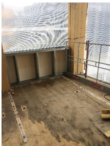
Bild 9. Vattenmarkeringar från missfärgat vatten på bjälklaget i etapp A. Pågående uppfuktning vid en vattenpöl. Hålen har frilagts från skyddstejp på grund av kondens enligt uppgift. Ytterväggarna har täckts in med plastfolieväv, 2018-04-16.
