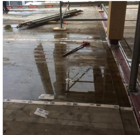
Bild 8. Tejpade skarvar, anslutningar och infästningshål. Stående vatten påträffades på bjälklaget, 2018-04-16.
