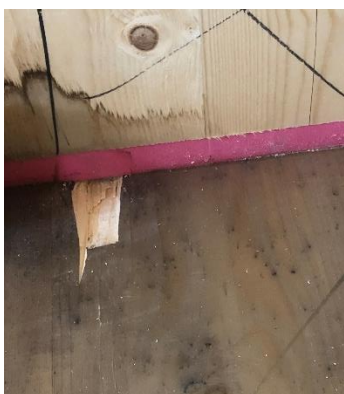
Bild 21. Uttaget prov av ovansida bjälklag under sylomer. Synliga fuktmarkeringar på nederkanten av väggen samt att bjälklaget blivit missfärgat av bland annat missfärgat vatten.
