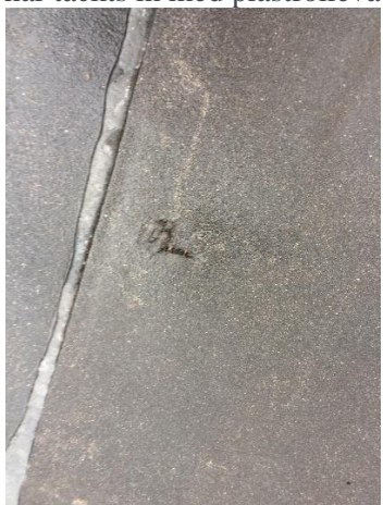
Bild 11. Hål har uppkommit i takpapp på terrassbjälklaget, 2018-04-16.
