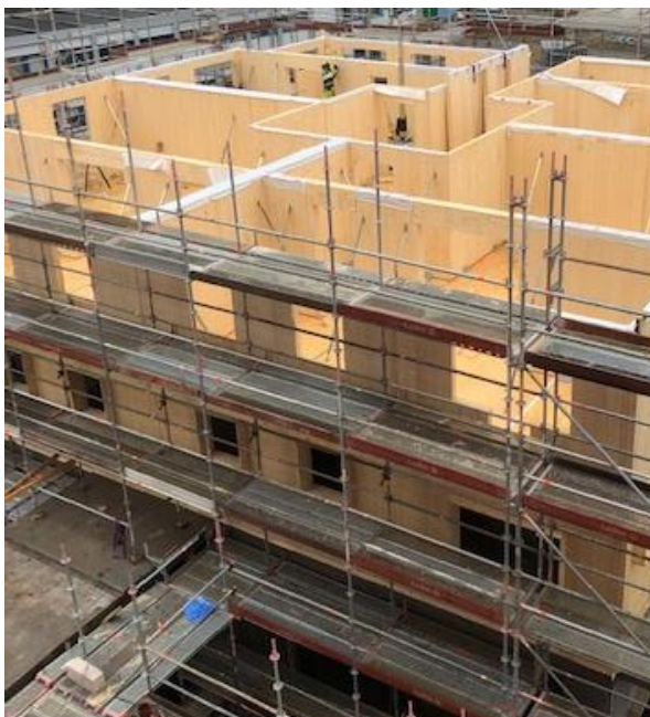
Bild 17. Stomresning av hus 1. KL-träbjälklaget var täckt med vatten. Dukar som skulle skydda ovkant av väggar hade släpp i blåsten, 2019-03-14.
