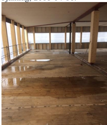
Bild 13. Många vattenpölar på bjälklaget, etapp 1, 2018-06-18.
