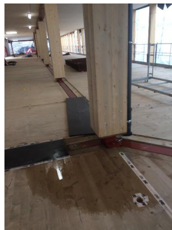
Bild 12. Vatten på bjälklaget, våning 3, 2018-04-16.
